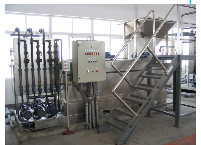
Préparation polymère Polymer preparation plant
