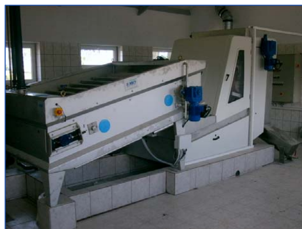
Pré-épaissement par table d'égouttage
