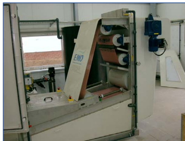
Installation dans un local
