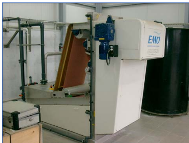
Installation dans un local
