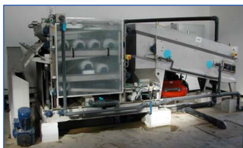
Pré épaississement avant déshydratation par filtre à bandes
