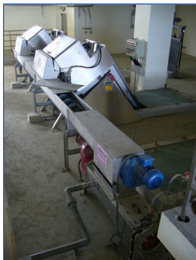
Une vis convoyeuse après un dégrilleur escalier
